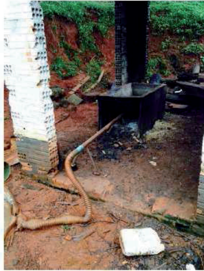
Figura 2.9: Queima do biogás
