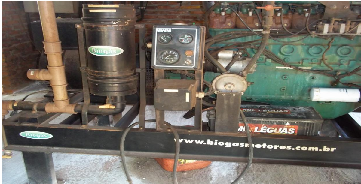
Figura 06 - Foto do Motor Instalado na Propriedade Fonte: Granja Gerhardt
