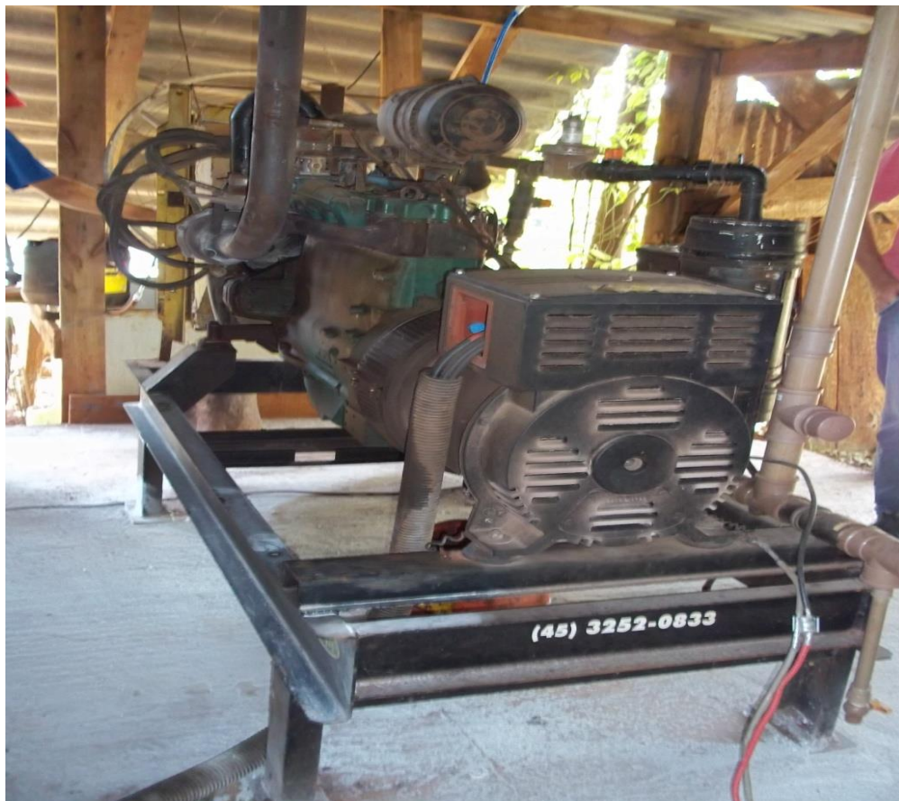
Figura 07 - Foto do Motor Instalado na Propriedade e os canos de transmissão Fonte: Granja Gerhardt
